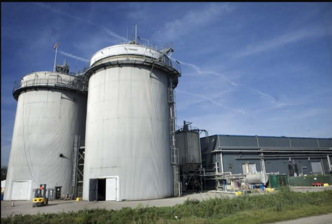
De vergistingsinstallatie voor de productie van groen gas uit organisch afval van afvalverwerker Omrin op Ecopark De Wierde in Heerenveen. Archiefphoto uit 2014. (Foto Maarten Hartman/ANP)
